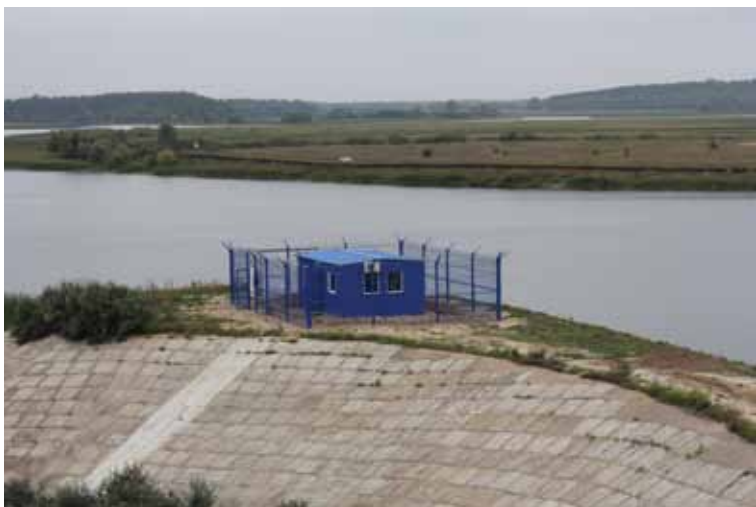
Рисунок 6 – Категорированный объект с установленным оборудованием Phoenix Contact
