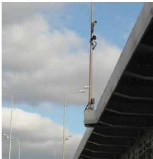
Рисунок 5 – Видеокамера, установленная на мосту, с питанием по Ethernet (PoE) и молниезащитой
